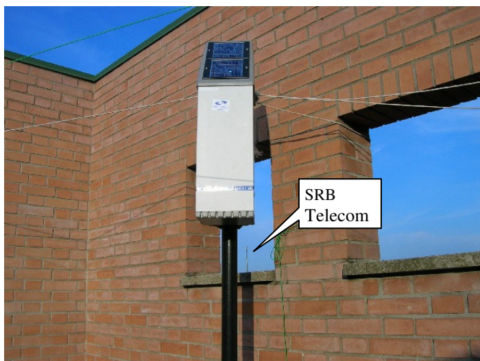
Figura 1 – Collocazione della centralina di monitoraggio in continuo rispetto alla SRB.
