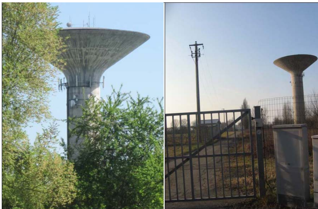
Figura 34 – SRB sulla torre dell’acquedotto ed elettrodotto aereo esistente
